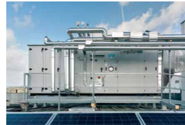
Figura 25: Esempio di un'installazione all'esterno
